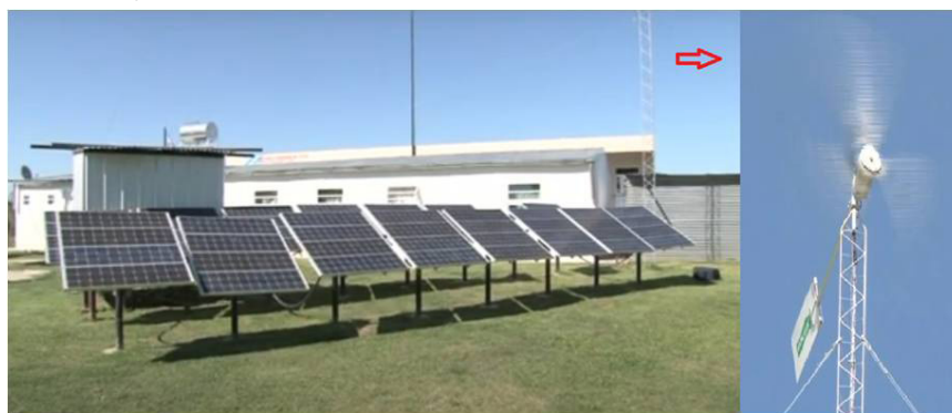
Figura 5. Instalación híbrida eólica-solar en Escuela N° 1312, Guaycurú
