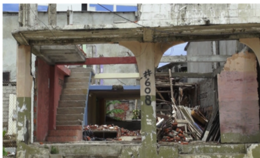
Figura 2. Casa destruida en San Roquel, 2016.
