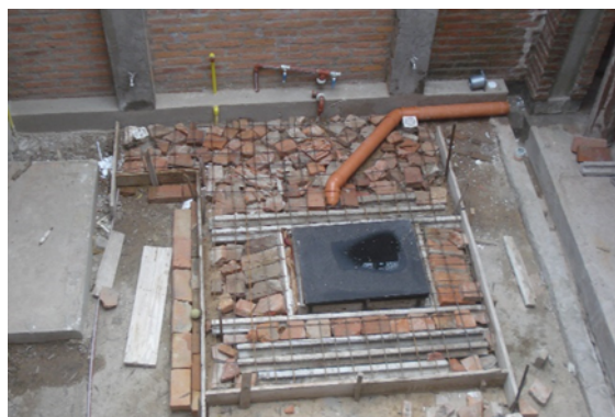
Fig. 22 Tanque reserva y bombeo
