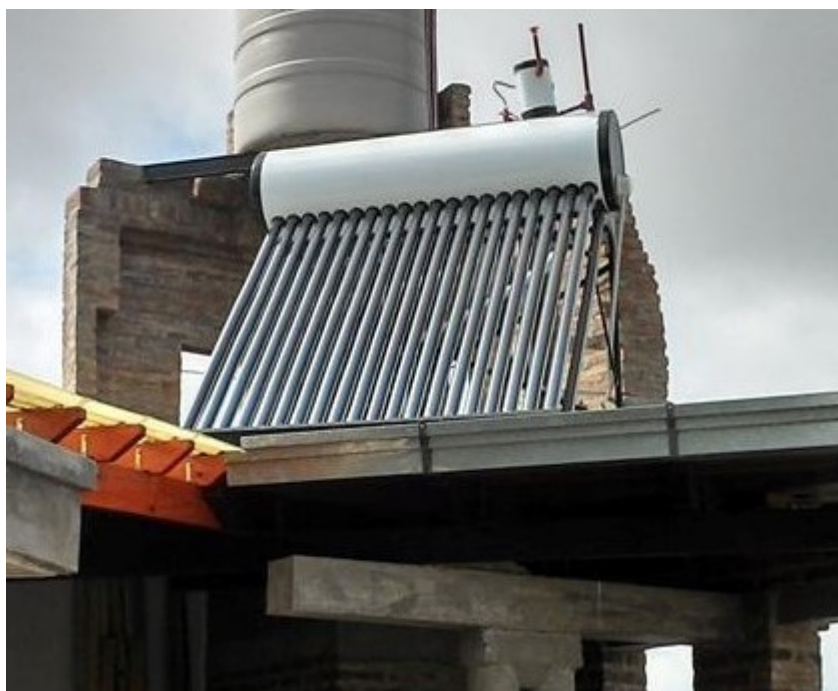
Fig. 18 Termotanque 200 litros ACS
