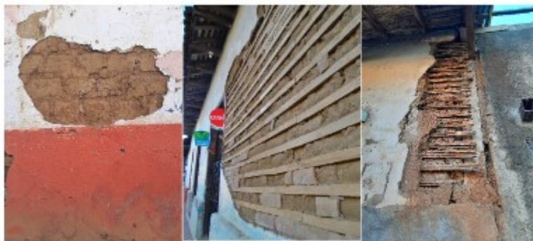
FIGURA 9. (Leer de izquierda a derecha) Muestra de adobe en el barrio de Sutiava, León. Taquezal expuesto en vivienda del barrio San Felipe, León. Albardeado o bahareque en el área de transición del Centro Histórico de Granada. propia.
