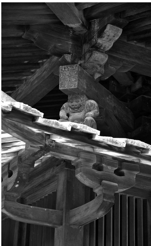
CHARPENTE D'UN TEMPLE AU JAPON. Les métiers du patrimoine considérés comme un patrimoine immatériel. Image: ©ICCROM.
