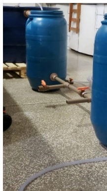
FIGURA 4 Decantador e seu sistema de drenagem e limpeza
